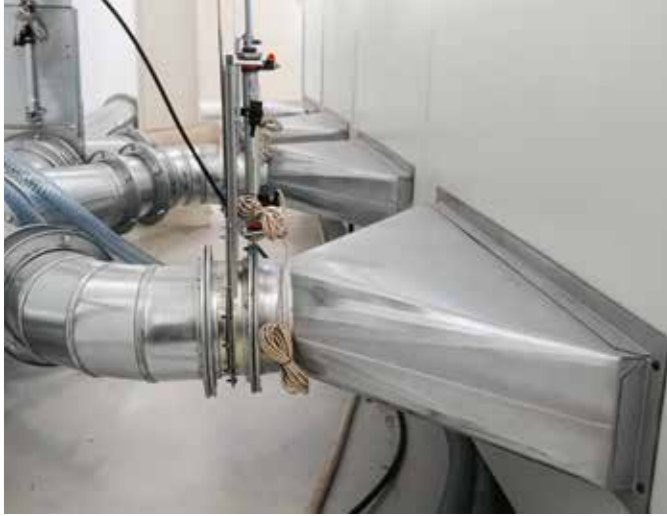
吸尘系统，有效为加工区域内部更换空气和除尘
